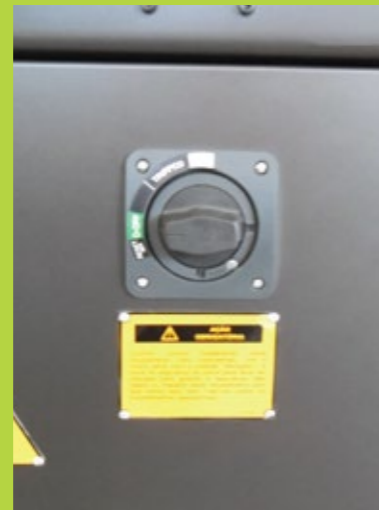
Chave seccionadora para o painel elétrico
